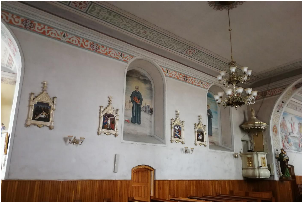
Fot. 10 Fragment ściany południowej w nawie z malowidłami ornamentalnymi i figuratywnymi
